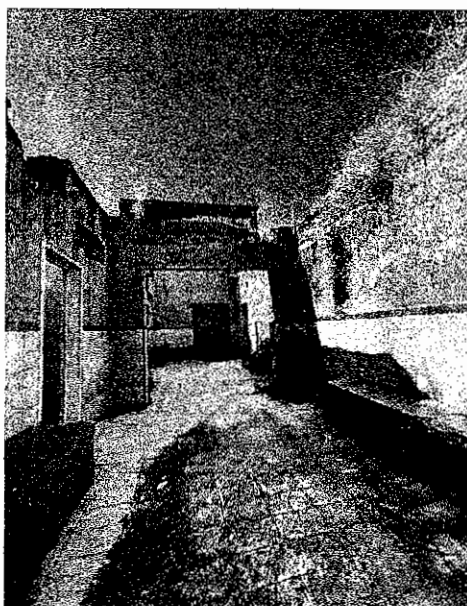
Fig. 01 – Área abandonada onde o telhado desmoronou: espaço passará por uma demolição par dar lugar à ampliação
