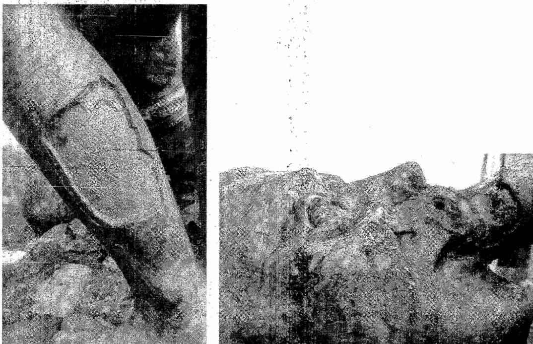
Detalhes da ferragem interna oxidada e das lacunas de profundidade que provocaram.
