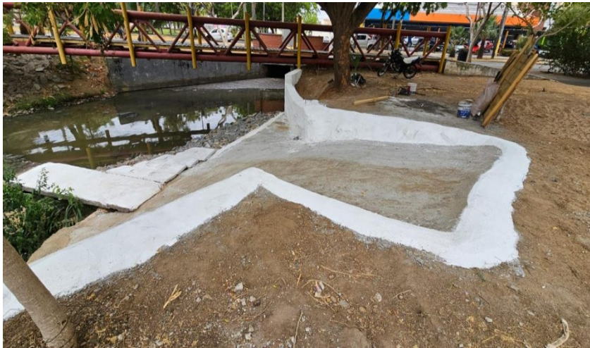
Figura 4: Rampa de acesso a máquina para para limpeza mecanizada na Caixa de Areia do Sistema de Jardins Biofiltrantes do Riacho Pajeú
