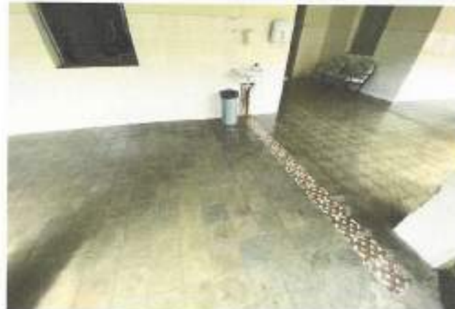
FOTO 03: PISO A SUBSTITUIR POR PORCELANATO FOSCO
