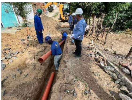
Figura 62 - Ampliação da rede de esgotamento sanitário nos bairros Sumaré e Padre Palhano.
