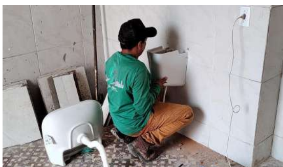
Figura 33 - Instalação hidrossanitária no pavimento superior do Abrigo.
