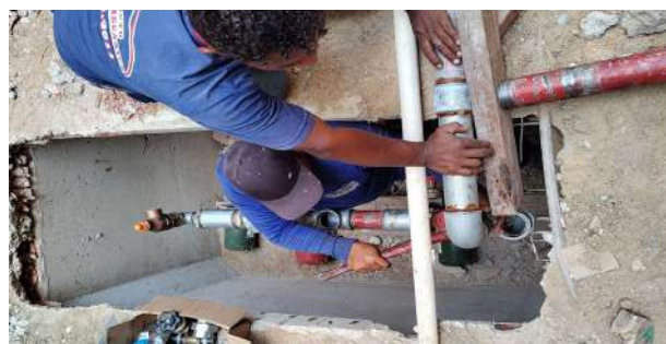
Figura 32 - Instalação de bomba da cisterna da reserva de incêndio do Museu Dom José.
