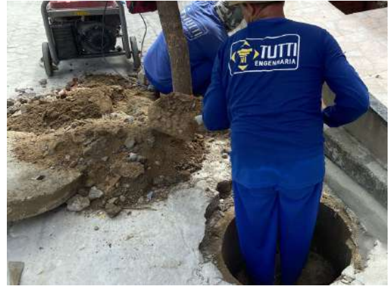
Figura 52 - Ligações Prediais no bairro Sumaré.
