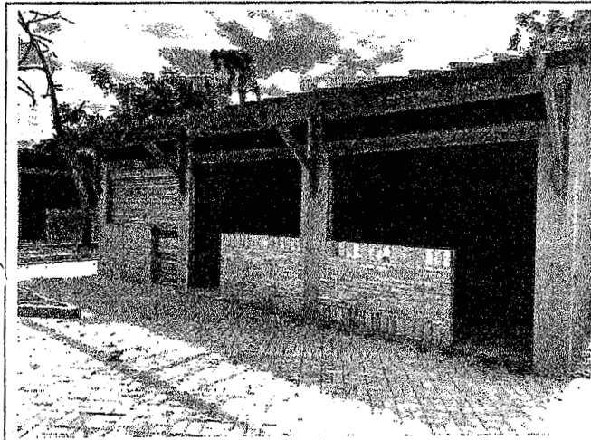
Boxes não concluídos
