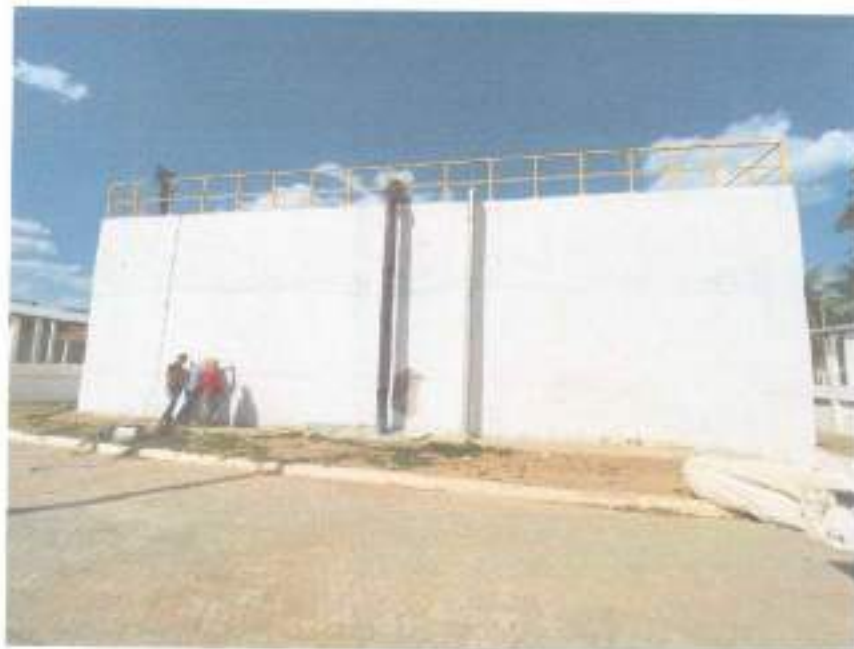
Figura 02 – Fissuração nos reatores UASB - ETE.
